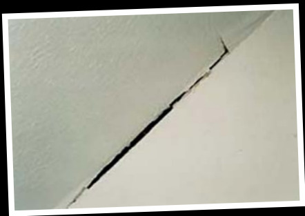
| Tassement différentiel typique dans les combles avec cloison en placoplâtre
